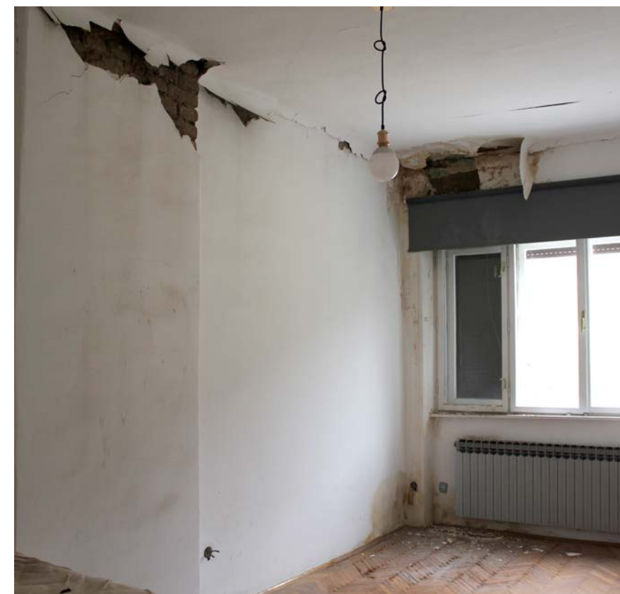
Sl. 38. Veća oštećenja u jednoj od prostorija drugoga kata
