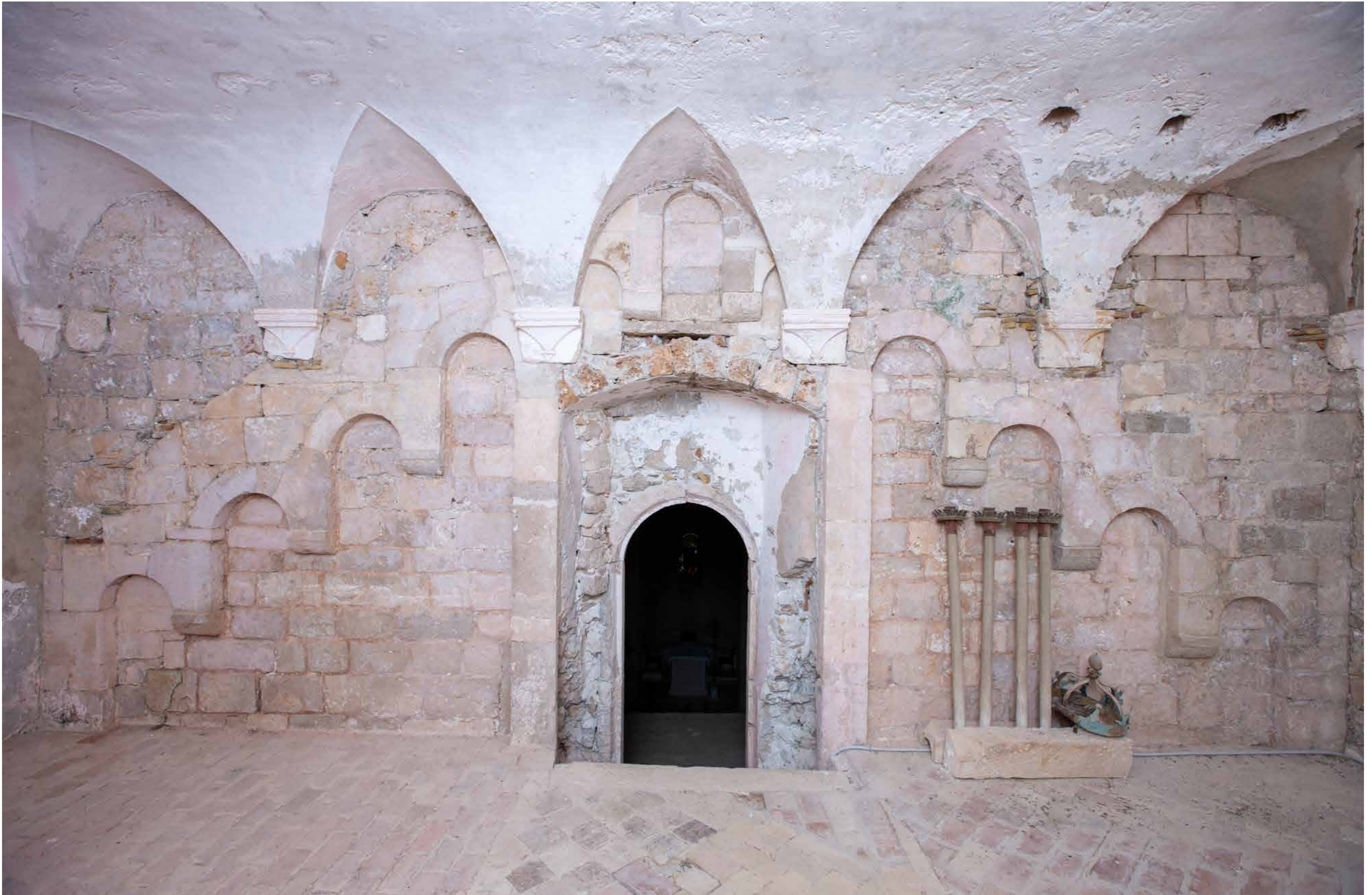
Zapadno pročelje crkve s visećim arkadama i naknadno smanjenim prozorom (biforom), pogled iz dograđene Gundulićeve kule
