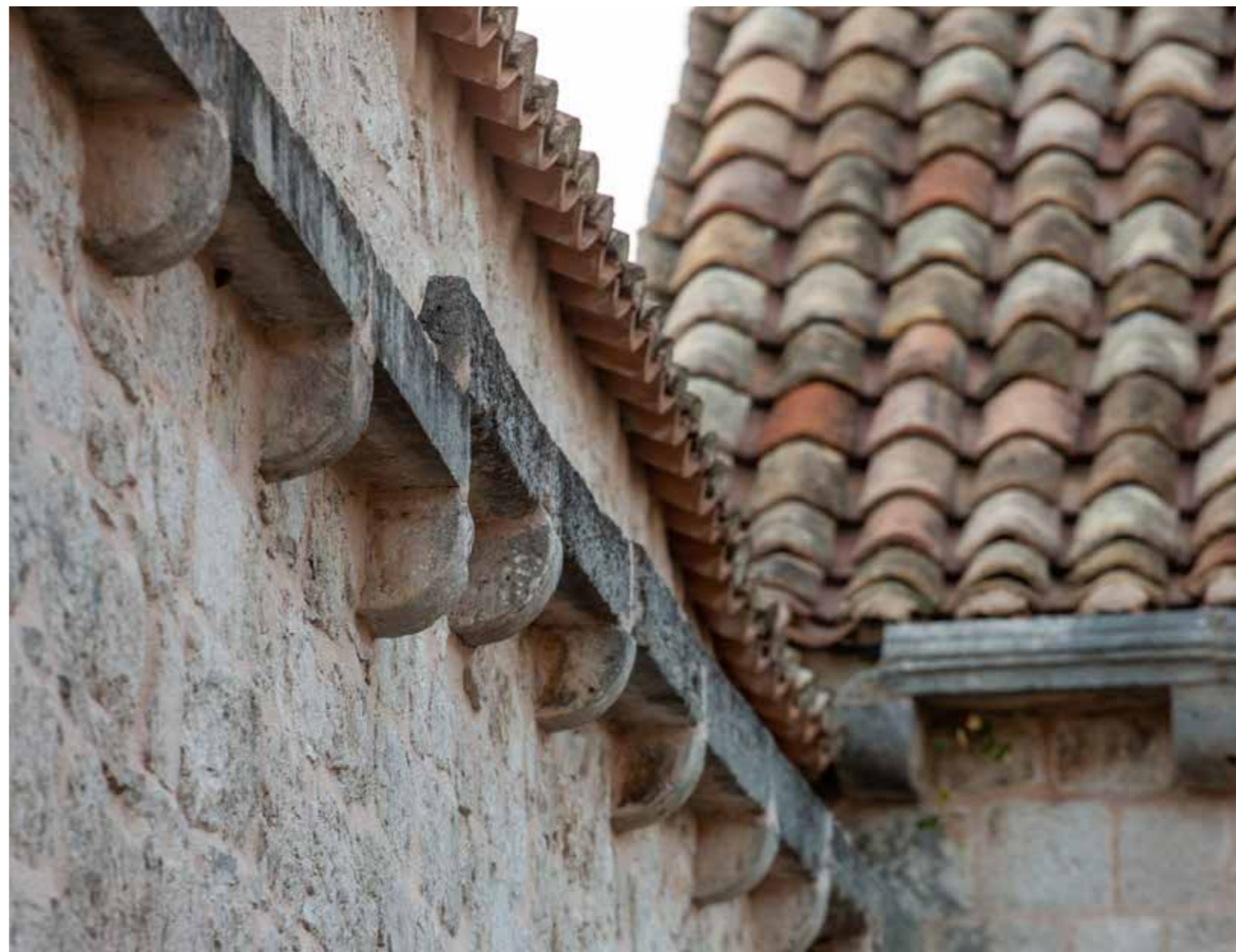
Sjeverno pročelje, žlijeb
